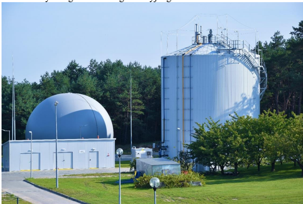
Fot. 3. Podstawowe obiekty całego układu kogeneracyjnego
