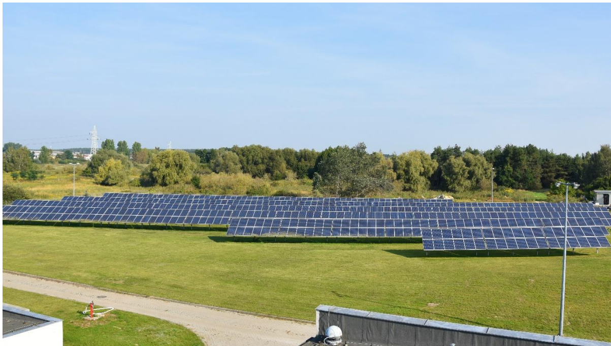
Fot. 1. Panele fotowoltaiczne na terenie ZWiK Sława
