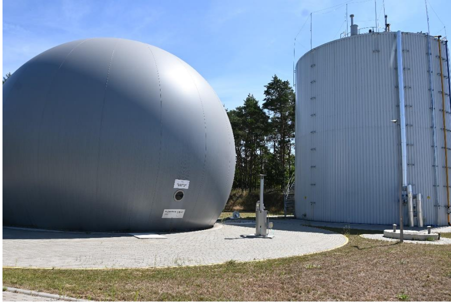
Fot. 1. Zamknięta komora fermentacyjna i zbiornik biogazu (4 x arch. spółki)
